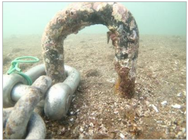
シンカーのU字金具の摩耗状況 右側の根元部分が摩耗している。
